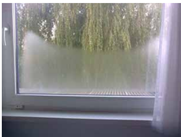
Bild 6: Tauwasser an der Außenscheibe.
